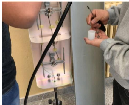
MP02: MANTENIMENT D'EQUIPS DE RADIOCOMUNICACIONS
